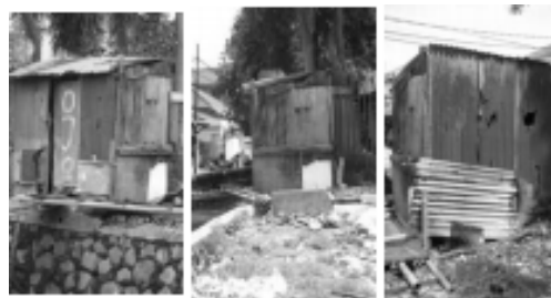
Gambar 3. Kondisi dinding permukiman kumuh
