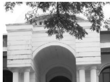
Gambar 25. Ornamen dinding eksterior yang kotor (Sumber: Hasil dokumentasi, 2010)
