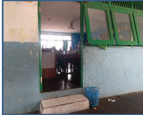
Gambar B. 4 Kondisi Akses Menuju Ruang Kelas
