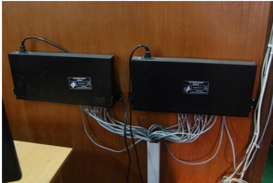
Gambar 4.2 Switch yang ada pada Labor Sistem Informasi
